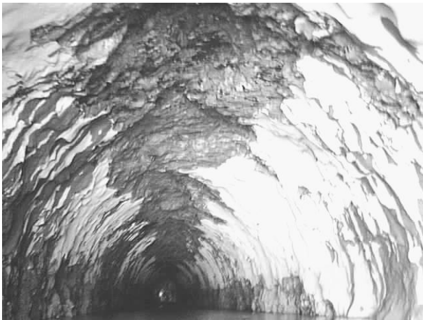
Figura 1. Ruptura contínua do teto (Capelas) no túnel da UHE Itá (foto gentilmente cedida por N. Intanti Jr.)
