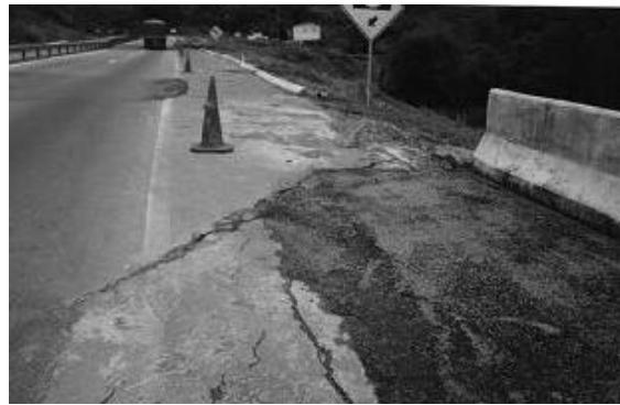
Figura 13: Ruptura adjacente à cortina atirantada
