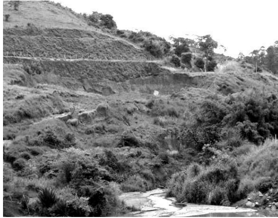
Figura 5: Vista geral do escorregamento e do córrego ao pé da encosta
