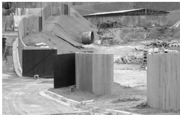
Figura 11: Bacia de acumulação de águas pluviais
