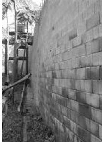
Figura 7: Embarrigamento do muro
