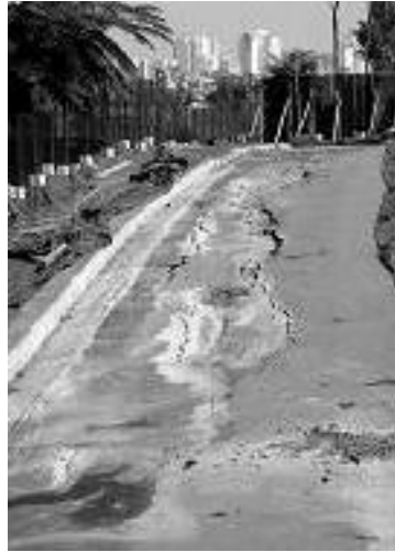
Figura 8: Trincas no pavimento acima do aterro
